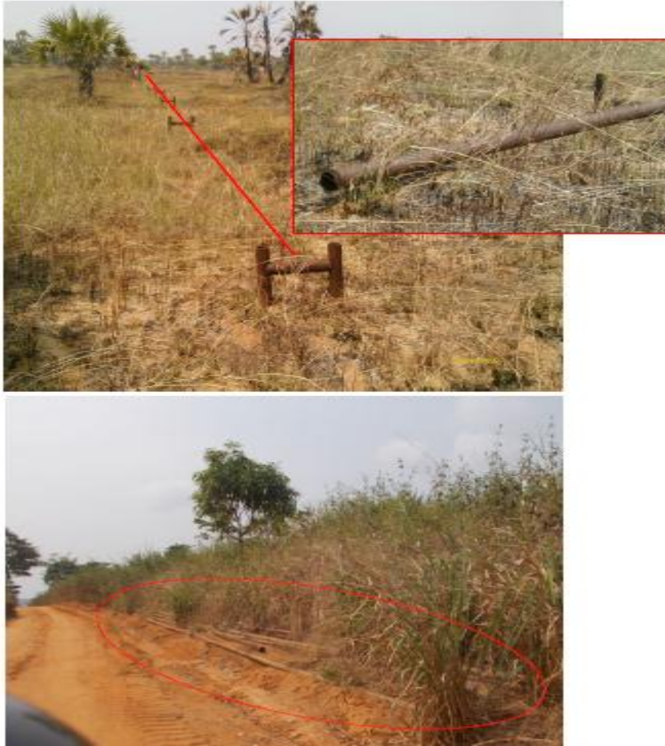
Photo n°57 : pipe-lines usagés provoquant des écoulements le long des infrastructures routières 44
