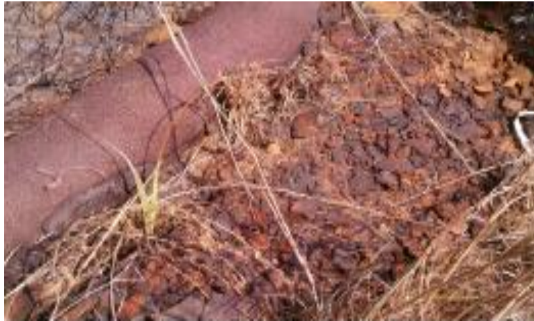
Photo n° 55 : corrosion des pipe-lines 42
