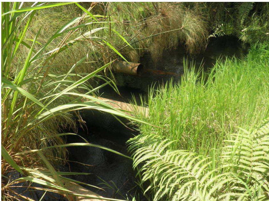
Photo n° 68 : Conduites de transport du pétrole sans gaine de protection 64
