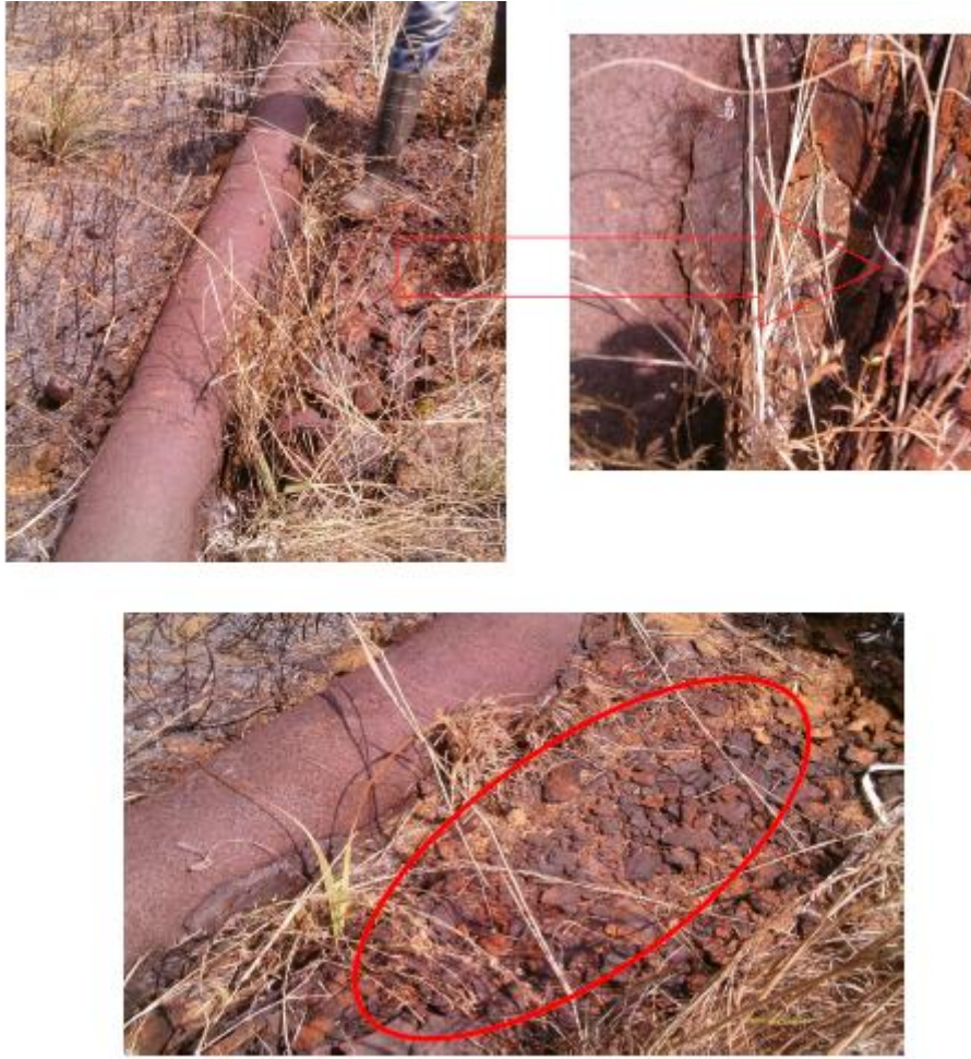
Photo n° 56 : pipe-lines usagés et abandonnés sur site 43
