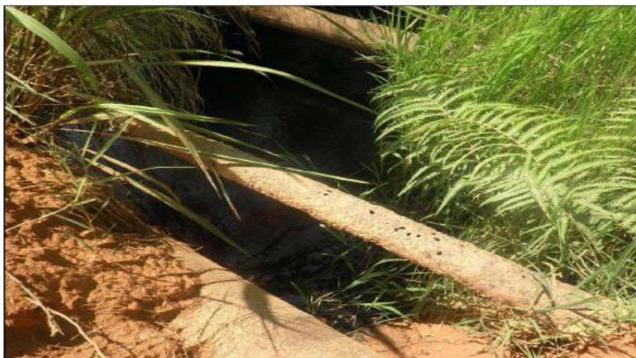
Photo n°24 : Vue de la vétusté du réseau de transport du pétrole à Muanda 11
