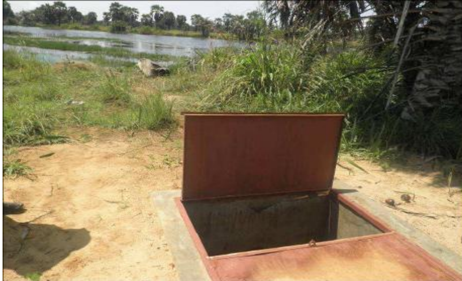
Photo n°25 : Rivière traversée par une conduite sans gaine de protection et véhiculant du pétrole 12
