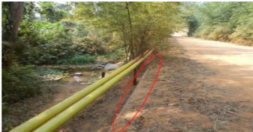
Photo n°58 : pipe-lines vétustes remplacés, mais abandonnés dans le sol 45
